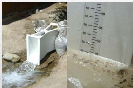
Canaleta Parshall en el canal de aducción
